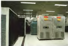
Non capita tutti i giorni di vedere un esemplare incartato come un regalo. Qui: un 4 Bui DF5500/927 che sta per sostituire i due DF550/92. Qui
